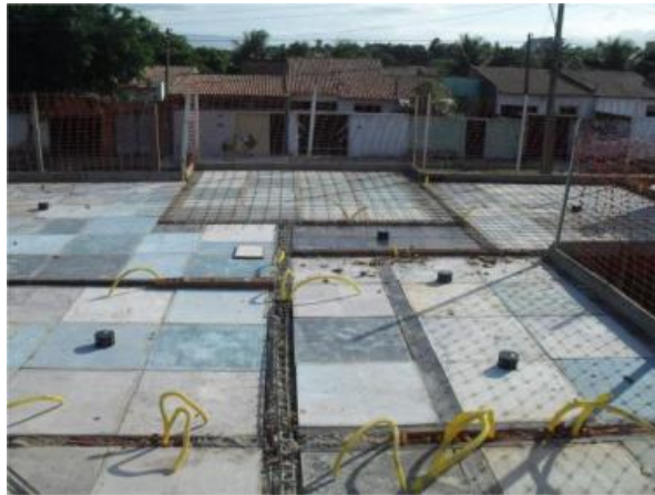
Figura 1 – Laje Maciça mostrando o assoalho feito pela fôrma modular Fonte: Autoria própria
